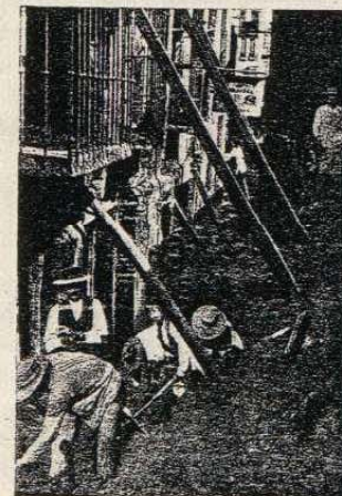
Calle de la Aurora.—Casas apuntaladas por temor a su derrumbamiento. Arrastres y lodos que alcanzaron la altura de los pisos principales.
